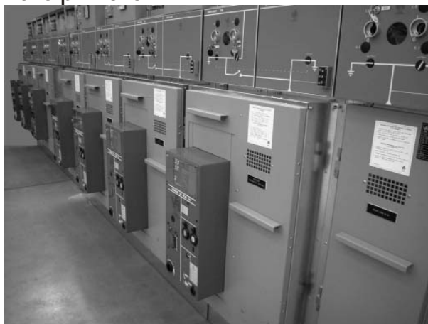
Пример распределительного устройства типа UNIFLUORC с силовыми выключателями VEIGAS
