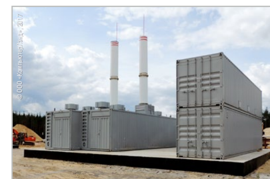
Блок-модули двухтопливной котельной 7 МВт
