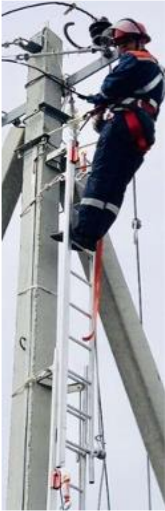
Рис. 13 Лестница, смонтированная на опоре 10 кВ
