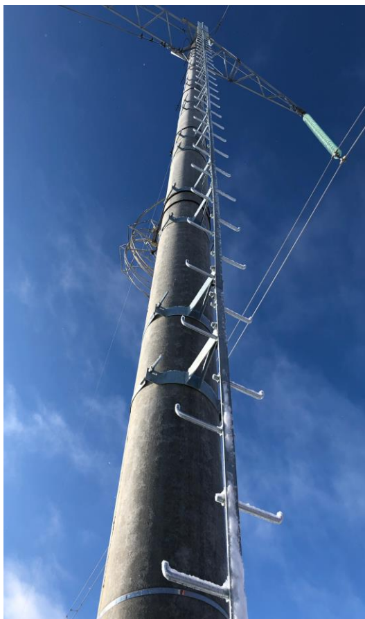
Рис. 14 Жесткая анкерная линия на опоре ПБ-500
